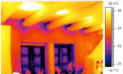
In condizione di depressione
